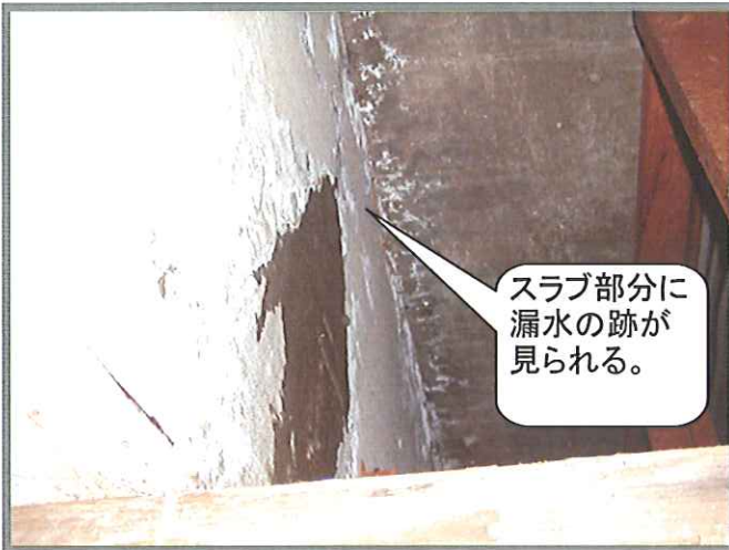
漏水部床面全景
