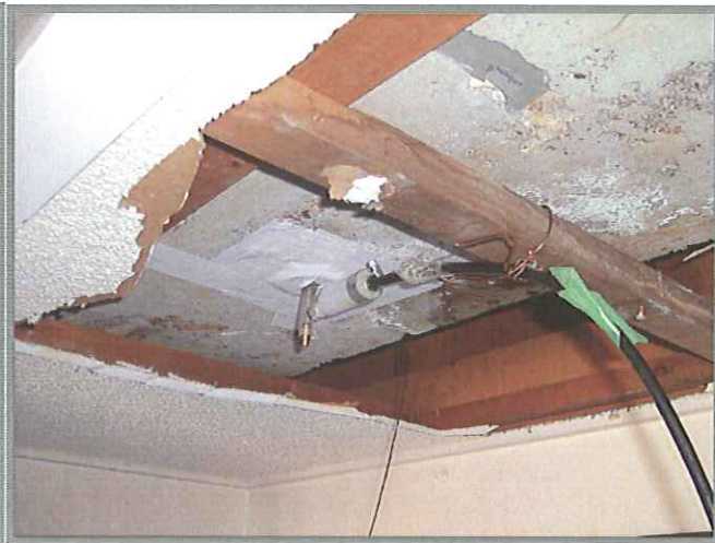
香り挿入口 設置状況
