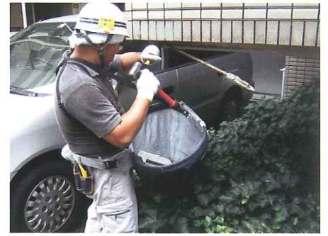
軒裏の鉄筋爆裂に
